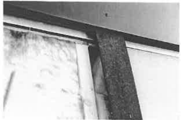
Foto 14. Dårlig udfyldning med isolering.
