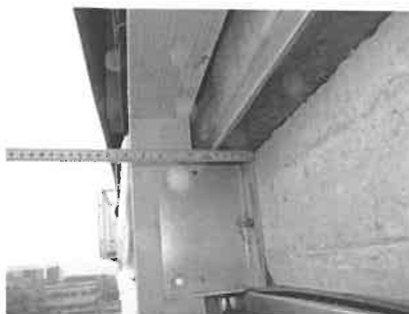
Foto 34. Måling af afstand til dækforkant – ingen isolering bag træskelet.
